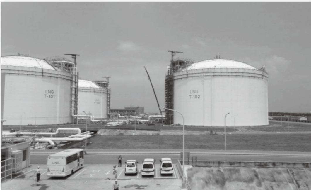
圖1.地上式LNG儲槽
