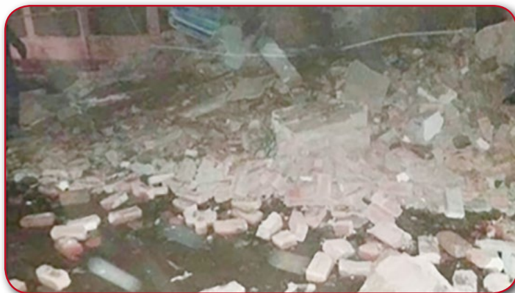
圖二 事故現場 部份建物磚牆倒塌
