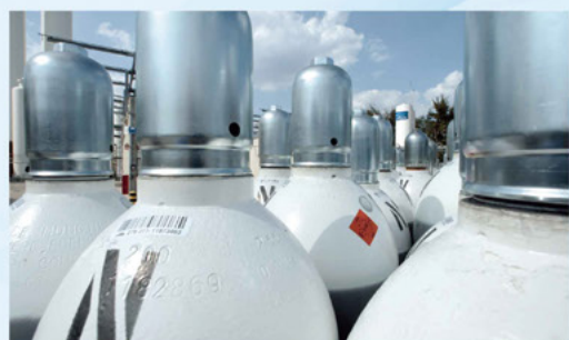
瓶裝氣體供應方案 Cylinder Distribution
