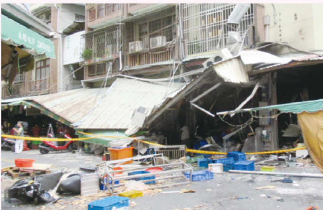
氣爆後之災害現場。(1樓屋外)
