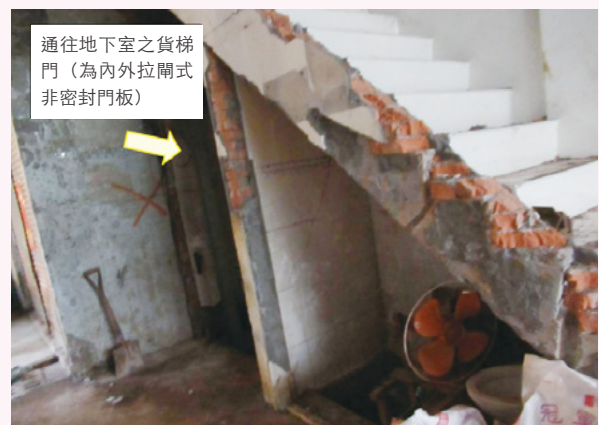
氣爆後之災害現場。(屋內建築物磚牆被炸倒塌)
