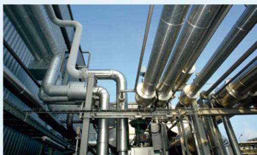
管路供應方案 Pipeline Distribution
