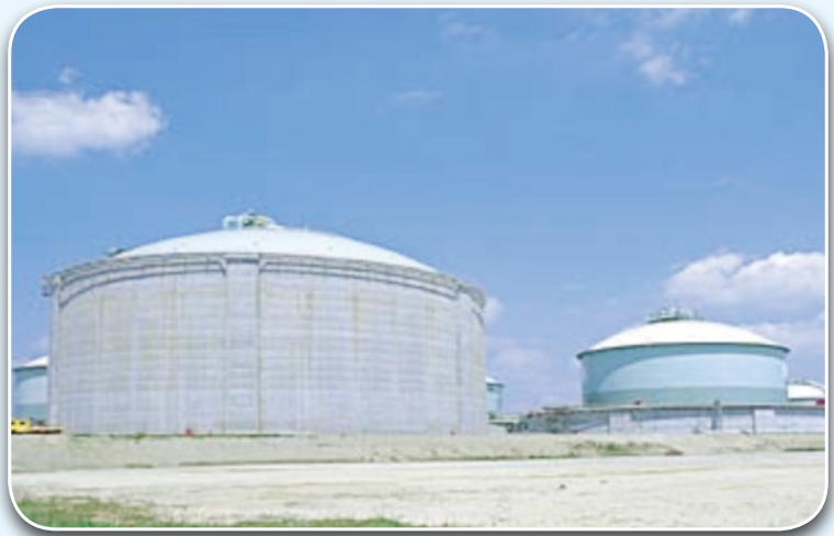
圖3.液化天然氣(LNG)儲槽
