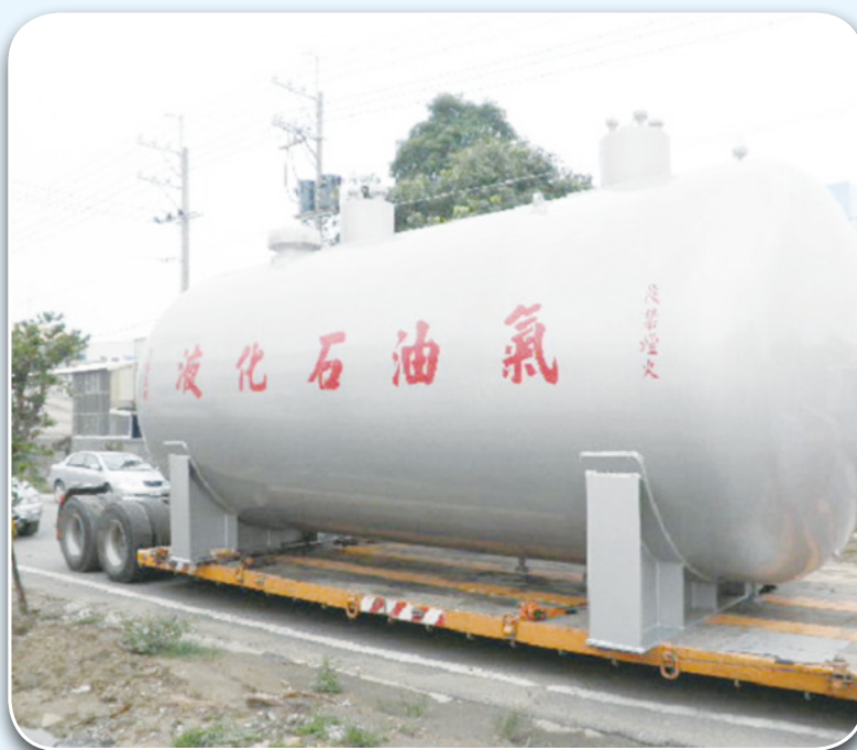
圖8.儲存區注意安全設施
