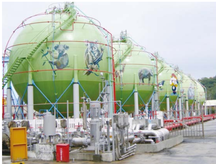
圖1.壓縮天然氣球形槽
